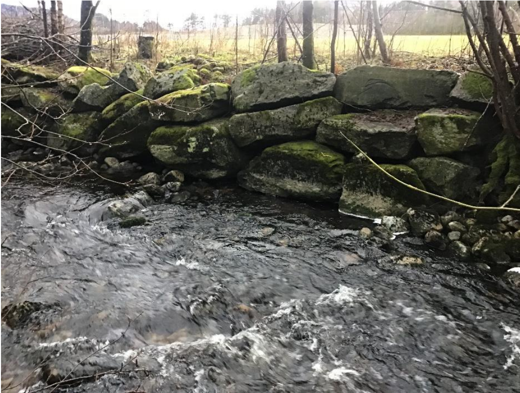
Figur 21. En av få tydelige erosjonssikringer i elvekantene, her i sone 5/6.
